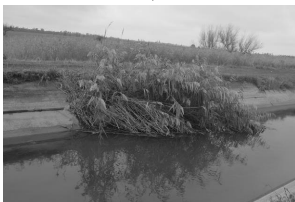
а – разрушенные деформационные швы; б – зарастание откоса камышовой растительностью
