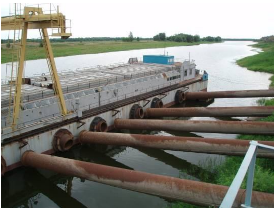
Рисунок Б.3 – Общий вид ПНС (СНР-6×1250 – 2-я станция)
