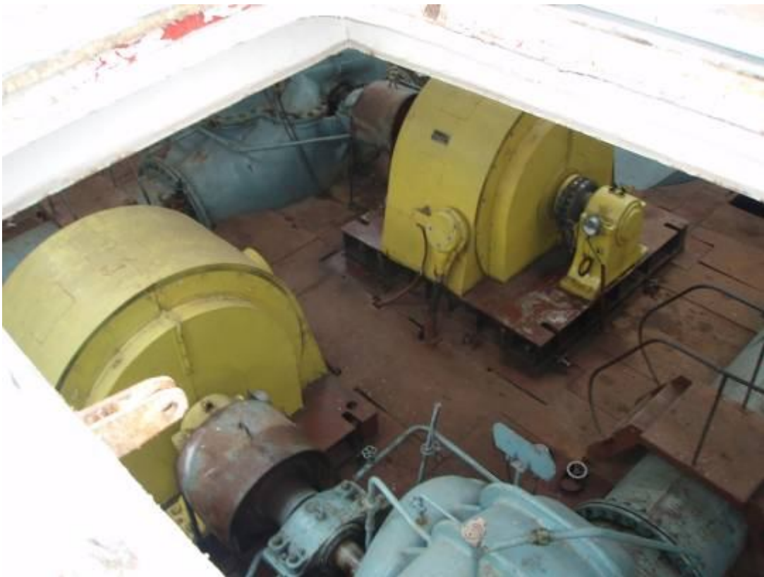
Рисунок Б.7 – Работающие насосные агрегаты ПНС (2 шт.)
