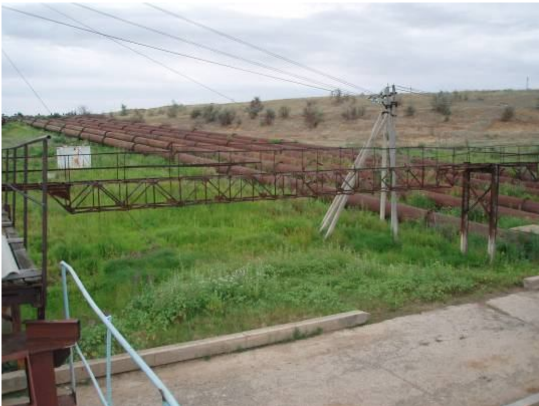
Рисунок Б.5 – Общий вид трубопроводов напорной сети ПНС
